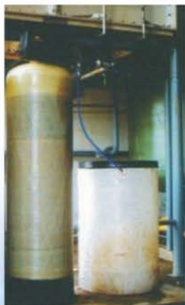
单阀单罐系统设备现场
