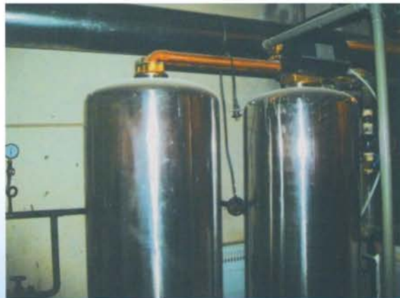
单阀双罐系统设备现场
