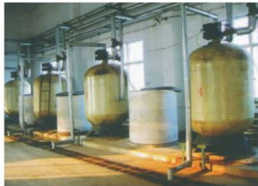
双阀双控系统设备现场
